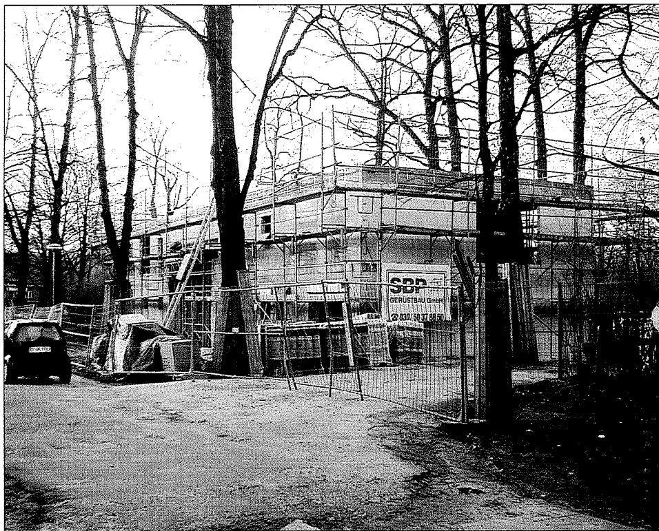
Es geht voran. Kürzlich war Richtfest beim „Rotterbau“, in dem die Geschäftsstelle des TuSli künftig zur „Untermiete wohnen“ wird...
